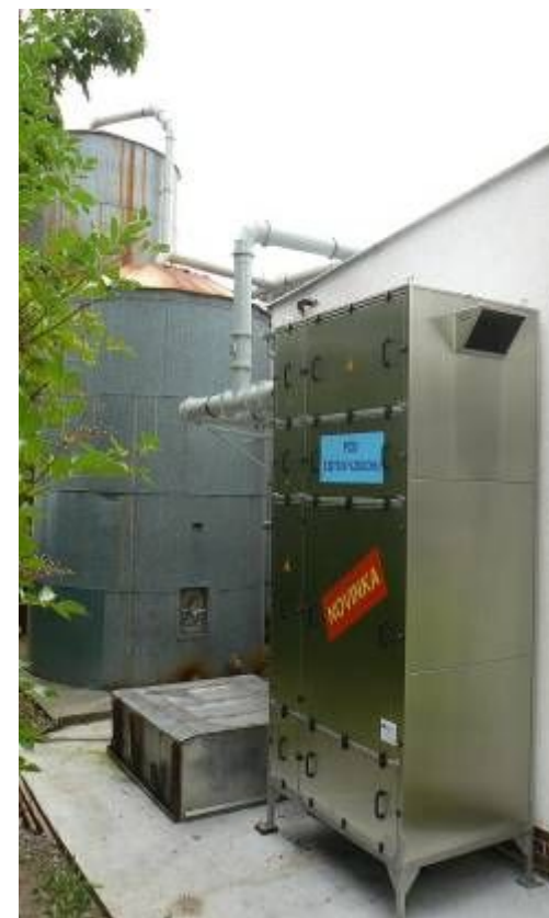
Connexions sur PCO depuis les 2 bassins d'activation
