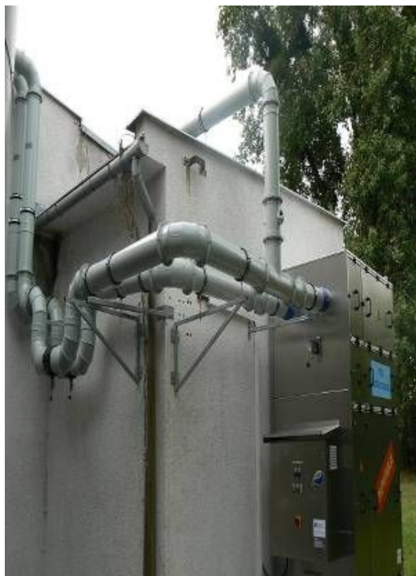
Connexion des 2 circuits sur unité PCO
