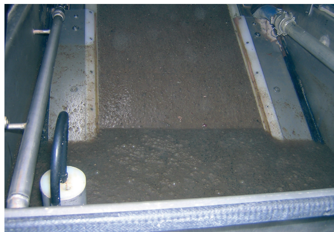
Boues dans le filtre SFT
